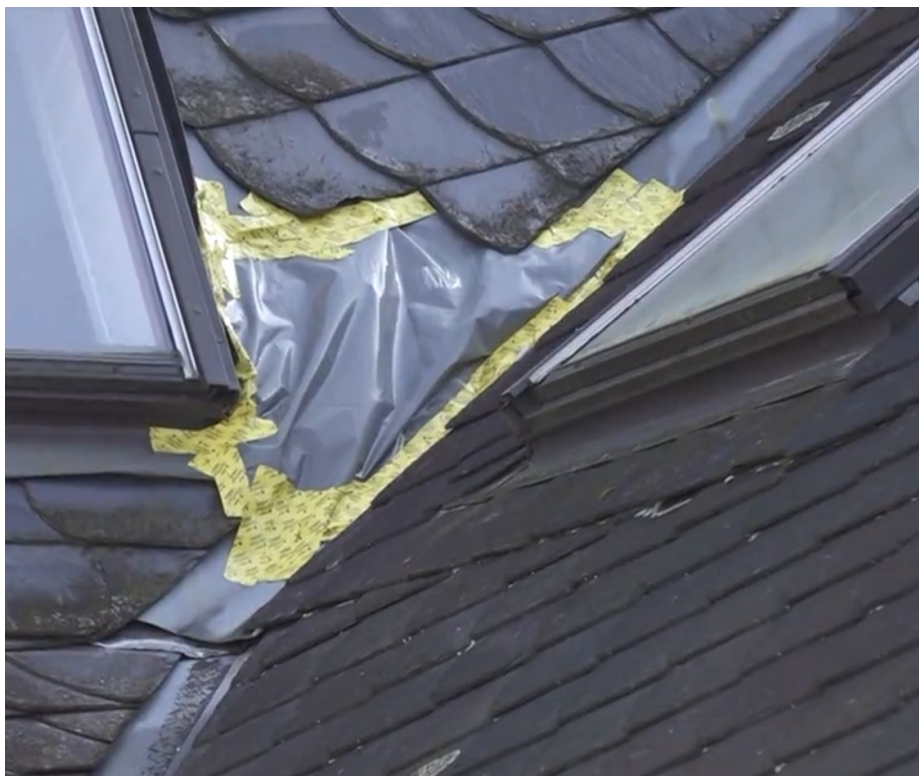
Figuur 6. Provisoirisch gerepareerde schade aan het dak van de getroffen woning te Koblenz. Verzekeringen vergoeden schade door natuurgeweld meestal niet, maar het schijnt dat zelfs de splinters van de dakpannen nog leuk geld opleveren... Foto: N-TV.
