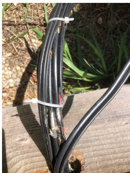
Figuur 7. Muizen... bescherm kabels buiten!
