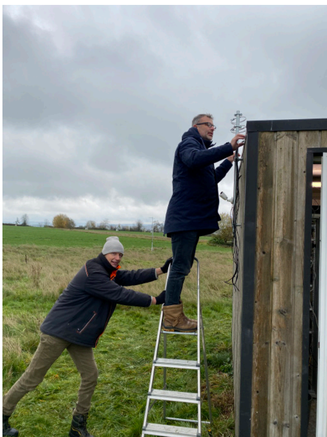
Figuur 6. De camerabevestiging wordt op een ARBO-technisch verantwoorde wijze aangebracht.
