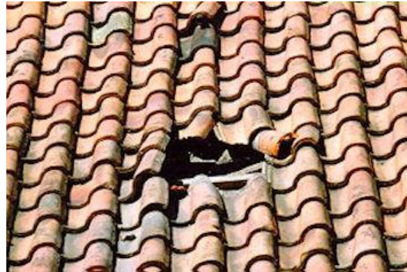
Figuur 2. Het beschadigde dak
