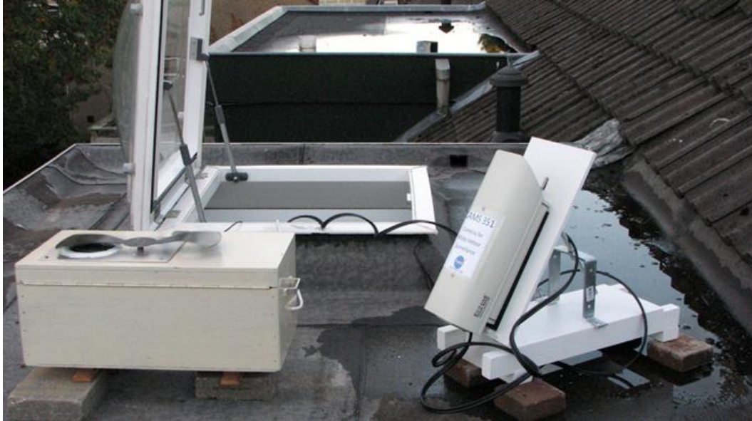
Figuur 1. Opstelling van post 351 te Ermelo op het platte dak van een dakkapel.
